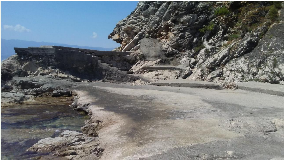
Grafički prikaz 6: Pogled na središnji i zapadni dio plažu sa šetnice - obalni zid ne postoji (Izvor: Izvedbeni građevinski projekt - Sanacija plaže Mikulova kava u Kostreni, MareCon d.o.o., Rijeka, srpanj, 2018.)
